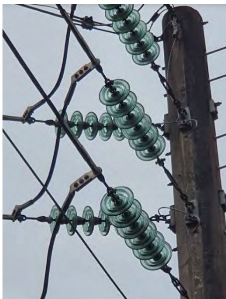
Figura 26 – Exemplo de isolador de vidro temperado.
