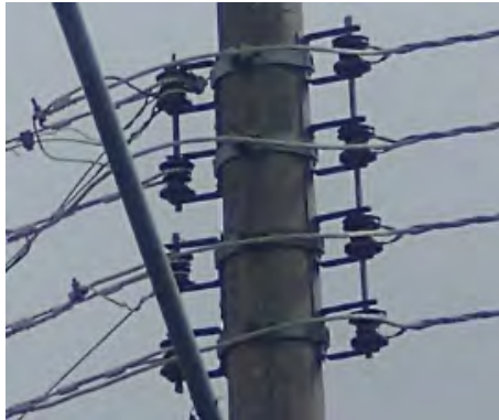
Figura 28 – Isoladores tipo roldana instalados em poste.
