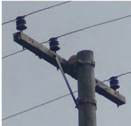
Figura 29 – Isoladores monocorpos do tipo pino instalados em poste.
