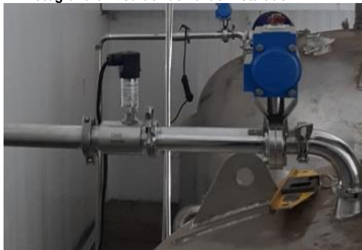
Fotografia 6: Medidor de vazão instalado
