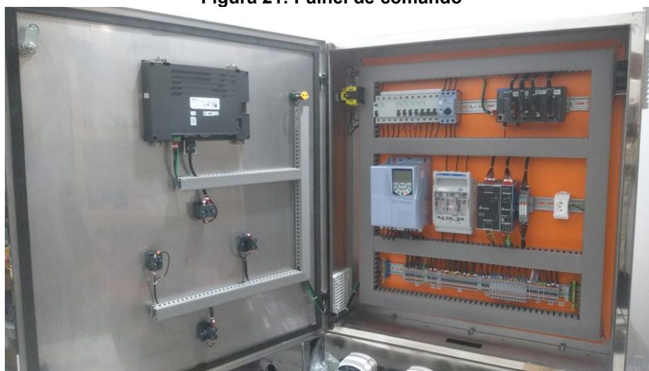
Figura 21: Painel de comando
