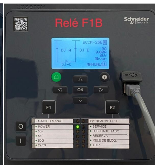
Figura 3: Frontal do relé F1B
