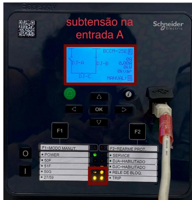
Figura 13: Mímico do relé F1A indicando a subtensão em A
