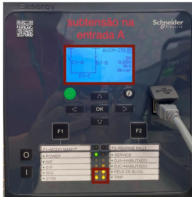
Figura 33: Mímico do relé F1A indicando a subtensão em A
