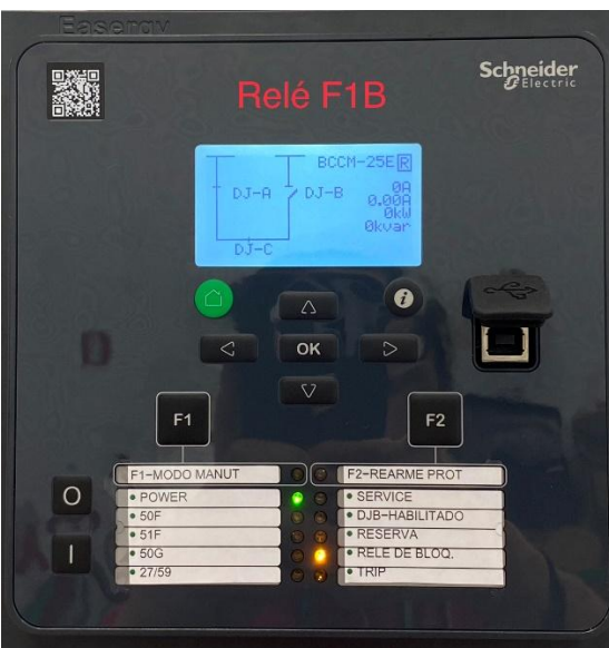
Figura 23: Frontal do relé F1B
