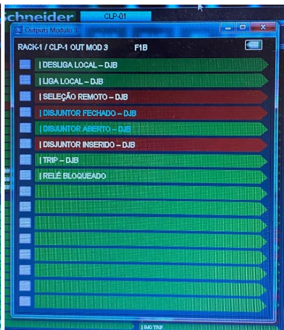
Figura 6: DIs do relé F1B
